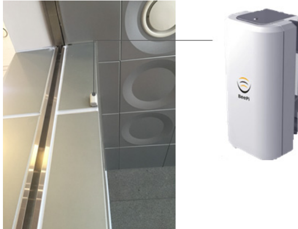
〈그림 4〉 도서관 출입구에 설치된 비콘 사진
